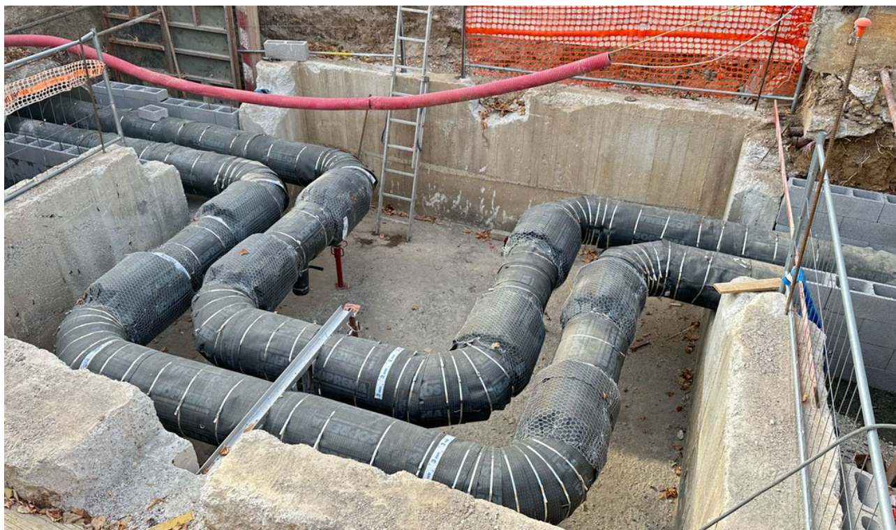
Fig. 8: Tubazioni per impianto di teleriscaldamento
